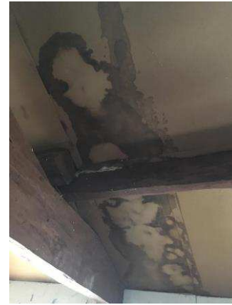
Infiltrations d'eau par la toiture
