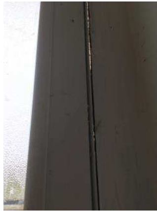
Infiltrations d'eau par les menuiseries
