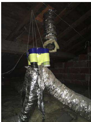
VMC non conforme
